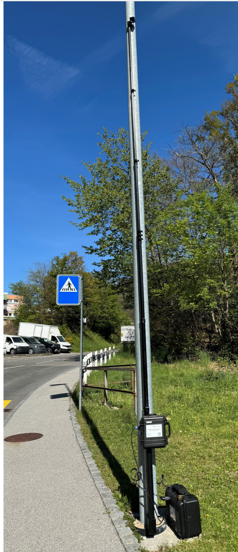
Installation du swissSCOUT à Bellinzone TI.
